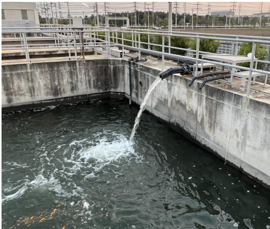
ภาพที่ 1 น้ำระบายจากหอหล่อเย็นของโรงไฟฟ้าพลังความร้อนร่วมแห่งหนึ่งในจังหวัดพระนครศรีอยุธยา ปริมาณ 25,590 ลิตรต่อชั่วโมง
