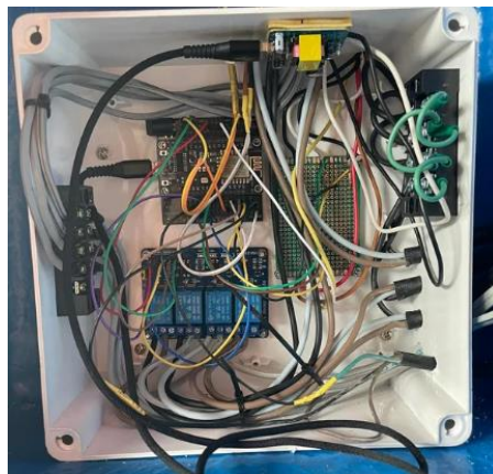
ภาพที่ 5 กล่องควบคุมตู้ล้างรถยนต์
