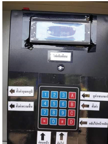
ภาพที่ 6 ตัวควบคุมหลัก
