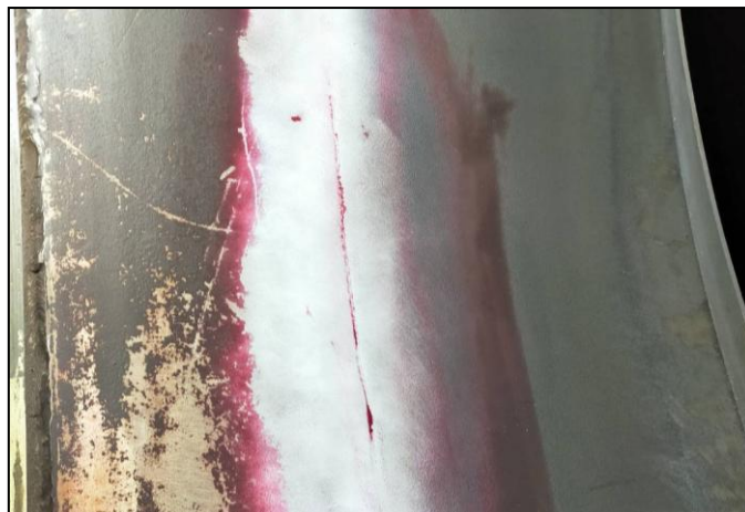
รูปที่ 2 บริเวณผนังด้านในใกล้ปากทางเข้าที่ตรวจพบรอยแตกร้าวก่อนทำการเชื่อมซ่อม
