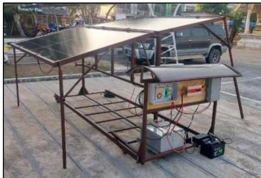
รูปที่ 4 สถานีชาร์จแบตเตอรี่รถจักรยานยนต์ไฟฟ้าด้วยพลังงานแสงอาทิตย์ แบบระบบ Off grid ขนาดแผง Solar Cell 1100 วัตต์
