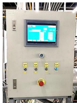
รูปที่ 4 เครื่องควบคุมลำดับ (PLC)
