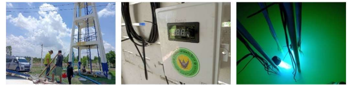
รูปที่ 6 การติดตั้งระบบฆ่าเชื้อโรคในน้ำประปาหมู่บ้านด้วยรังสีอัลตราไวโอเลตแบบอัตโนมัติเข้ากับระบบประปาหมู่บ้าน
