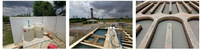
รูปที่ 5 การติดตั้งระบบเติมสารส้มแบบอัตโนมัติที่โรงสูบน้ำดิบ
