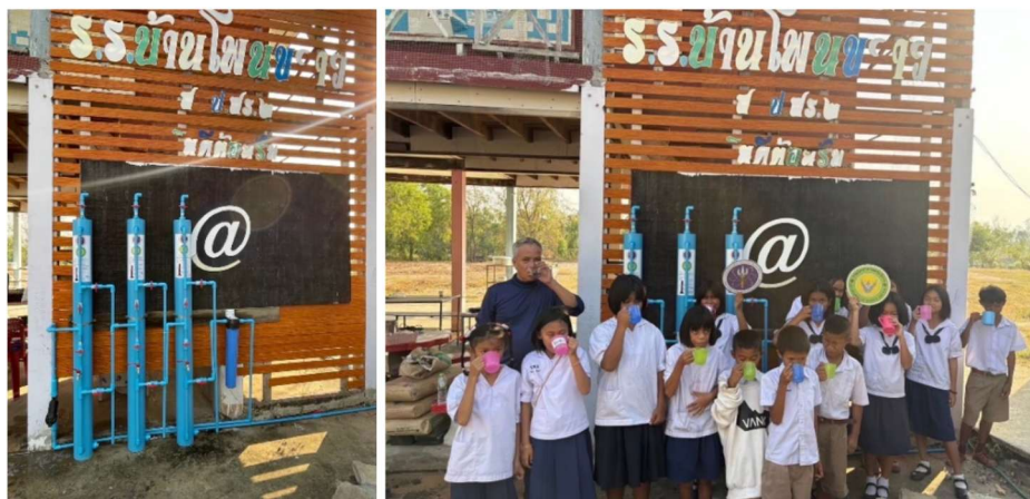
รูปที่ 7 ติดตั้งเครื่องกรองน้ำดื่มเทคโนโลยีกรมวิทยาศาสตร์บริการ ณ โรงเรียนบ้านโพนขาว หมู่ 2 ตำบลโพนครก อำเภอกำแพง จังหวัดสุรินทร์
