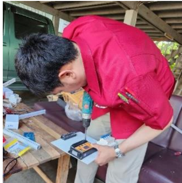
ภาพที่ 6 ติดตั้งอุปกรณ์ควบคุมไฟฟ้าและโซลาร์เซลล์
