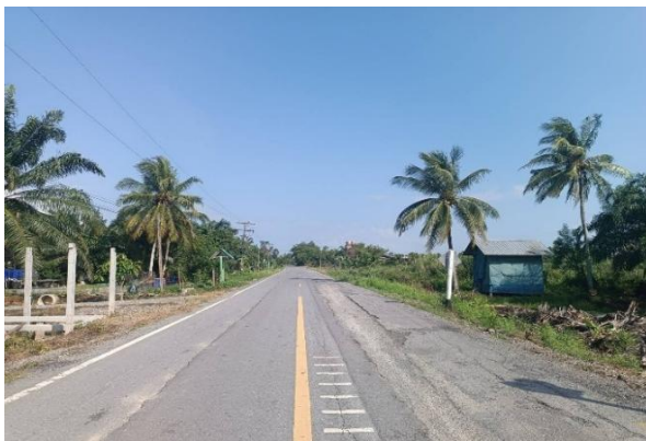
ภาพที่ 2 ความเสียหายของโครงสร้างทางในพื้นที่อำเภอปากพนัง จังหวัดนครศรีธรรมราช
